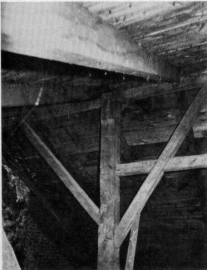
Charpente du toit refaite il y a environ 75 ans. Plusieurs pièces ont trois côtés gossés à l'herminette et le quatrième à la scie saint-joseph. Ces pièces de type ancien (mortaises, tenons, fiches) proviennent probablement du toit original.
